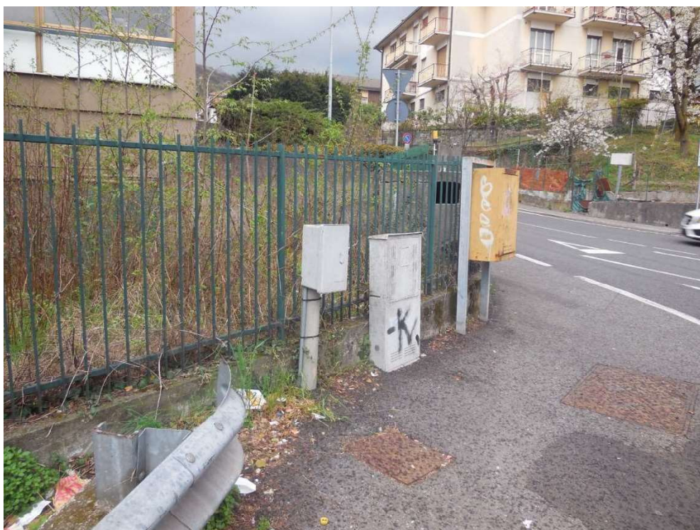
Contatore esistente per la fornitura di energia elettrica
